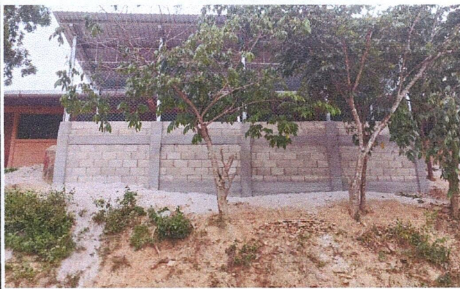
Foto 7: Area donde se realizó Mejoramiento de muro de contención, mejoramiento de muro perimetral, Mejoramiento con estructura tipo portico y lámina troquelada calibre 26 y Mejoramiento de losa de piso.
